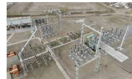
Línea Santa Cruz Norte: LAT 132 KV Pico Truncado-Caleta Olivia: de 53 km.
