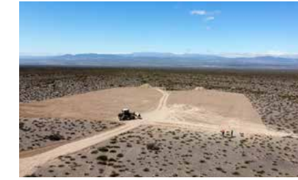
Parque Solar Zonda (100 MW).
