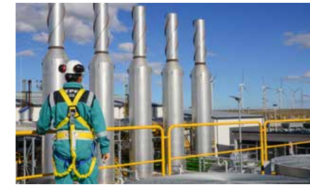
Central Térmica Manantiales Behr, de 58 MW.
