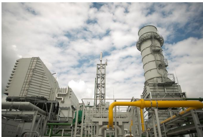
Central Térmica El Bracho
